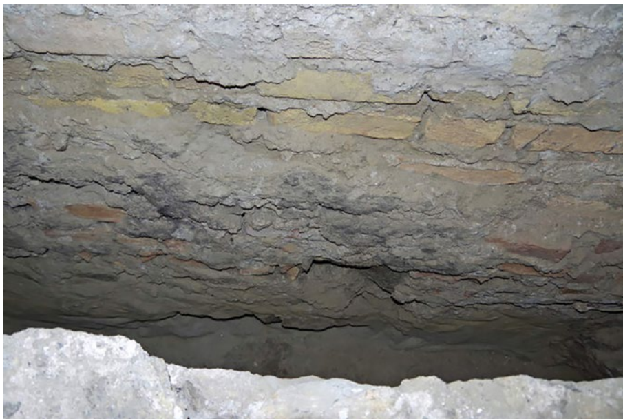
▲ Obr. 7. Šamorínsky kostol – základ severnej steny presbytéria – západná časť s rozdielnym charakterom murív. Foto: A. Botek.
