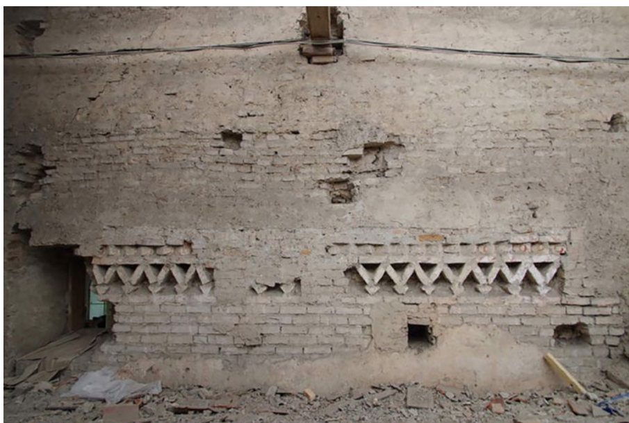
▲ Obr. 8. Šamorínsky kostol – bývalá severná obvodová stena – exteriér. Pod vlysom z III. etapy sekundárne kapsy trámov prestrešenia, pod nimi zvyšky omietky s výmalbou. Foto: A. Botek.
