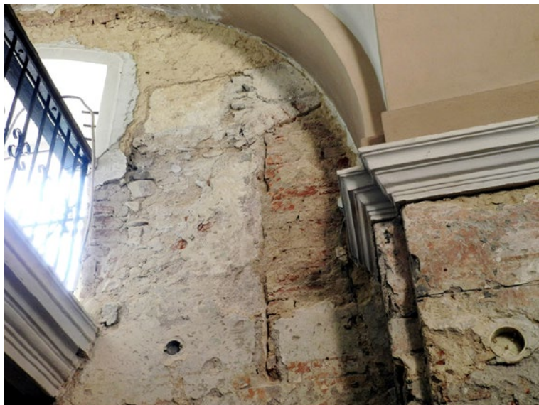
▲ Obr. 10. Zamurované vrcholnobarokové okno severnej steny lode. Foto M. Bóna. Fig. 10. Walled Late Baroque window on the northern nave wall. Photo by M. Bóna.
